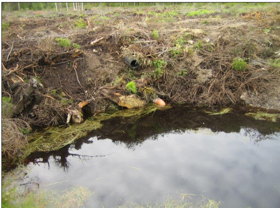
Figur 8. Exempel från Finland på en metod för att reglera höga vattenflöden "Peak runoff control" genom att installera rör på olika höjd i dammvallen. I bilden är det nedre röret oranget och det övre röret grått. Foto: Antti Leinonen.
