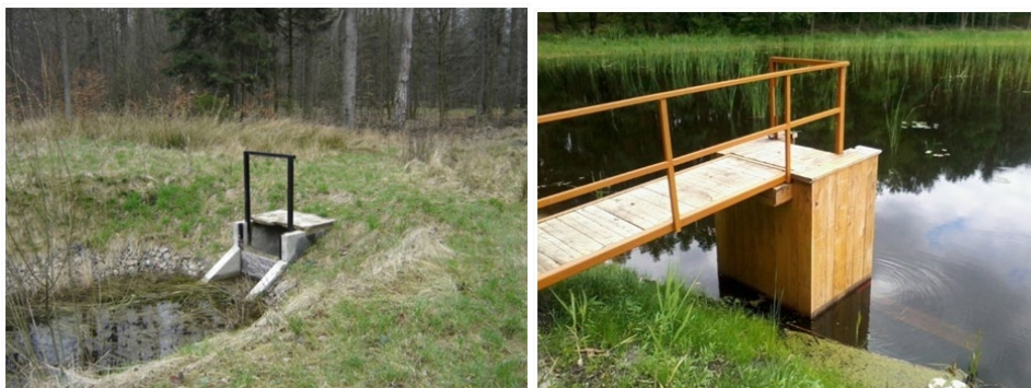
33 pav. Hidraulinės konstrukcijos, kontroliuojančios vandens nutekėjimą iš rezervuarų. Nuotraukos autorius Michał Wróbel.
