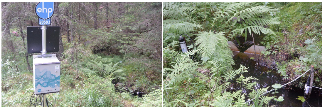
Bild 36 och 37. Mätutrustning i Övre Pollacksbäcken. Till vänster en översiktsbild och till höger närbild på Thomsonöverfall och sensorer. Foto: Carolina Lind
