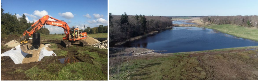
Figur 1. Vänstra bilden visar anläggande av regleringsmunk. Foto: Olof Engstedt. Högra bilden är en översikt över gäddfabriken. Foto: Linus Gradin.
