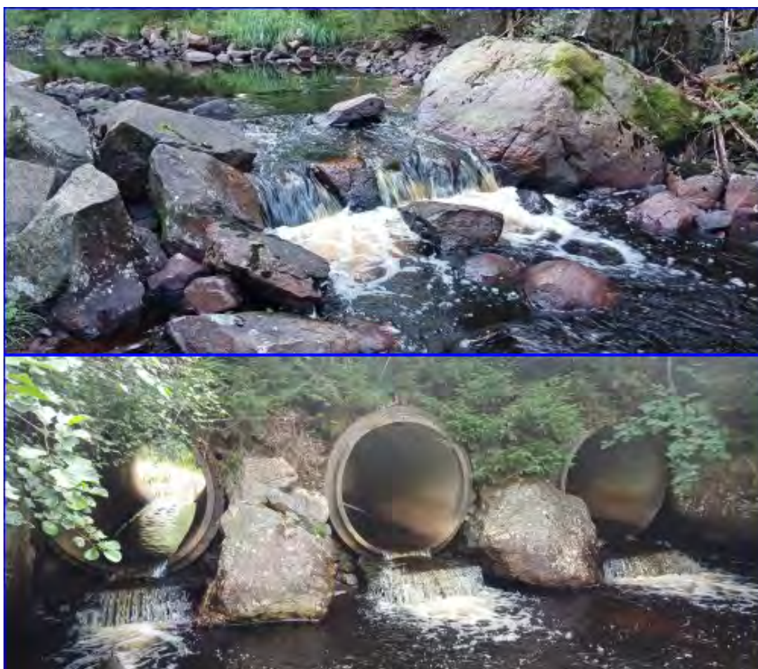
Figur 9: Vandringshinder som påträffades i Slien del 1. Överst: Hinder nummer 1 som består av en rest från en gammal bro. Underst: Hinder nummer 2 som består av vägtrummor med för höga trösklar.
