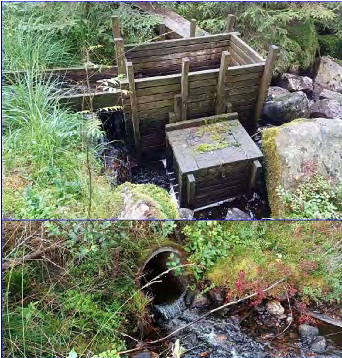
Figur 44: Exempel på vandringshinder i WA17694348. Överst: Hinder nummer 2 som utgörs av en gammal ålkista. Underst: Hinder nummer 3 som utgörs av en vägtrumma.
