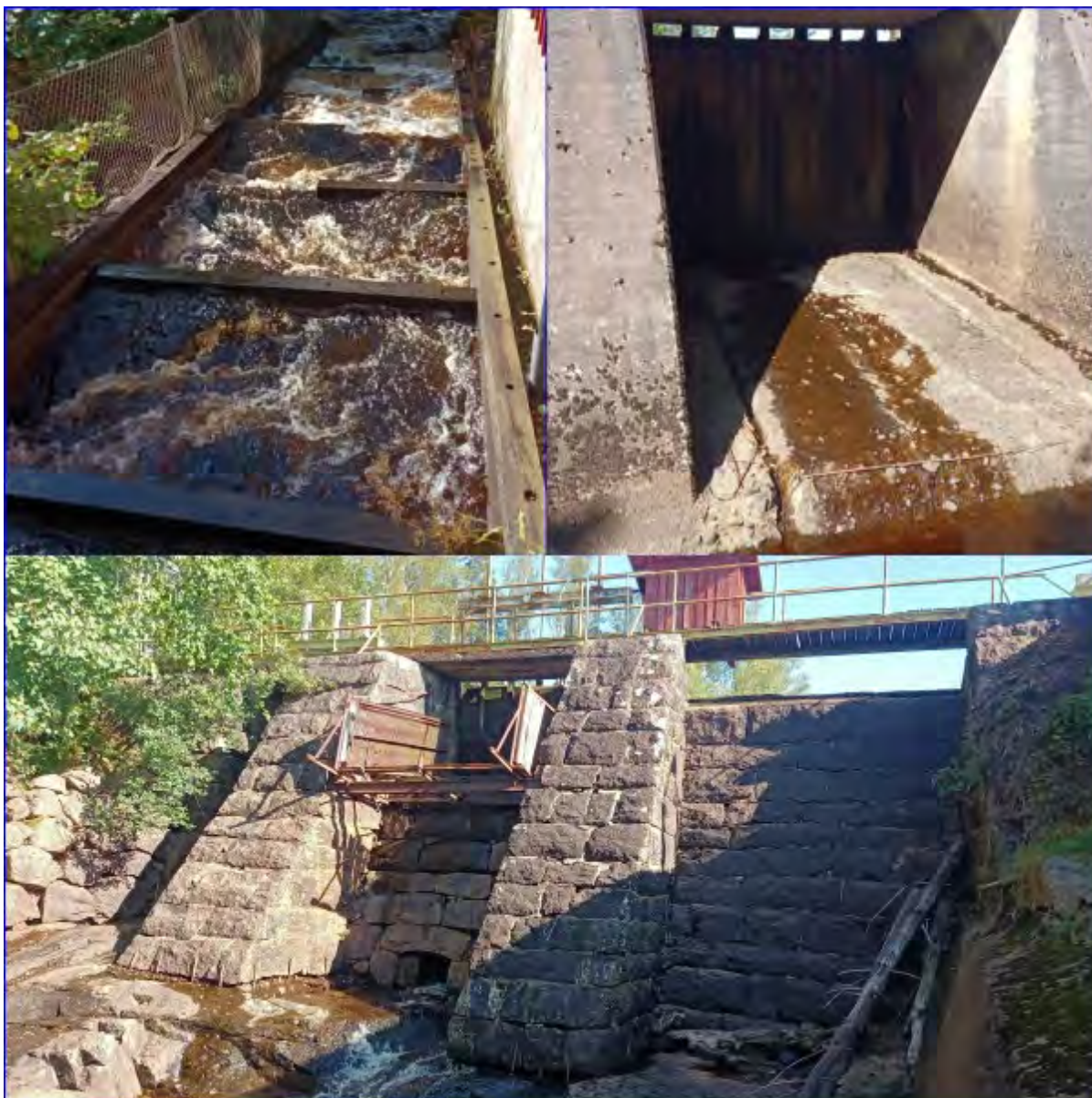
Figur 53: Vandringshinder i Högvadsån (Skärshultaån-Mjöaån). Överst till vänster: Kammartrappa vid hinder nummer 1. Överst till höger: Stängd lucka med läckage vid hinder nummer 3. Underst: Hinder nummer 2.
