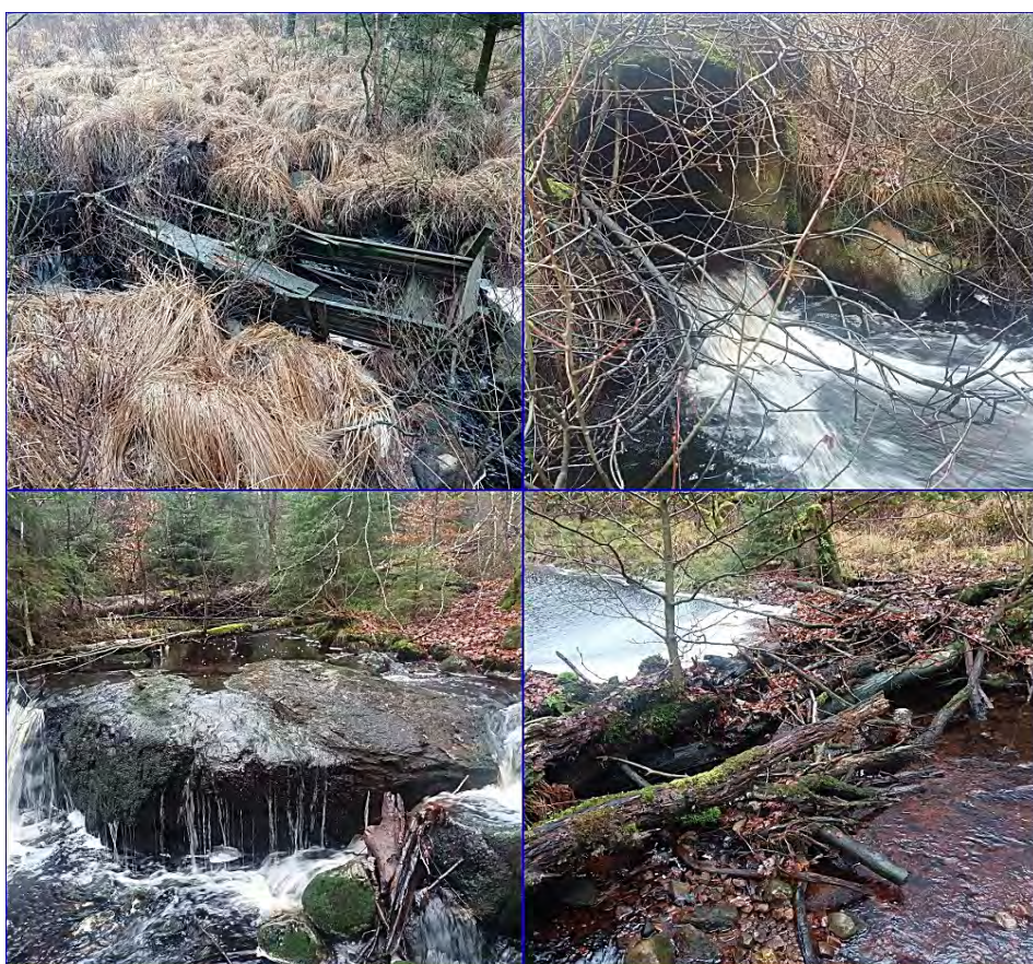
Figur 51: Exempel på vandringshinder i Alslövsån/Börjeån. De två översta bilderna visar två onaturliga vandringshinder i form av ålkista (7) och vägtrumma (6). De två nedre bilderna visar två naturliga vandringshinder i form av klippor (3, delvis naturligt) och död ved (1).
