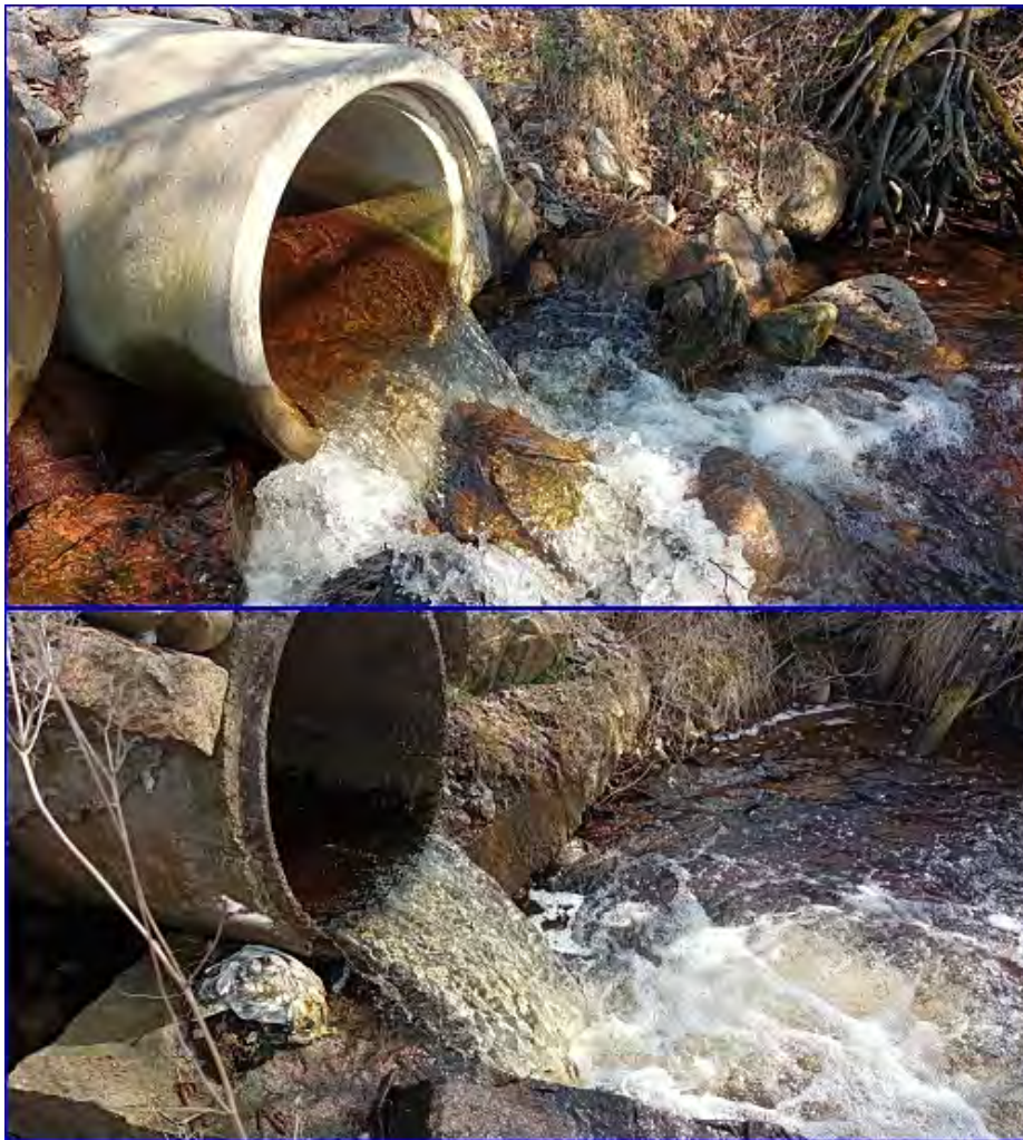
Figur 106: Exempel på vandringshinder i form av vägtrummor i Prästabäcken (D1 övre bilden, D2 undre bilden).
