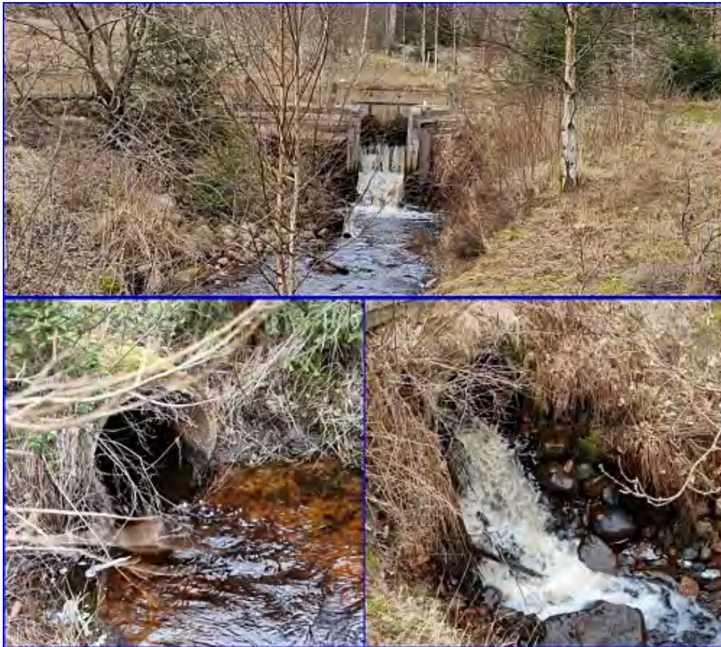
Figur 94: Översta bilden visar en trädgårdsdamm som tidigare har hört till sågverket i Björkelund. Undre bilden till vänster visar en felaktigt lagd trumma som vid låga flöden kan skapa ett vandringshinder. Undre bilden till höger visar en vägtrumma som utgör ett definitivt hinder för öring (vandringshinder 2).
