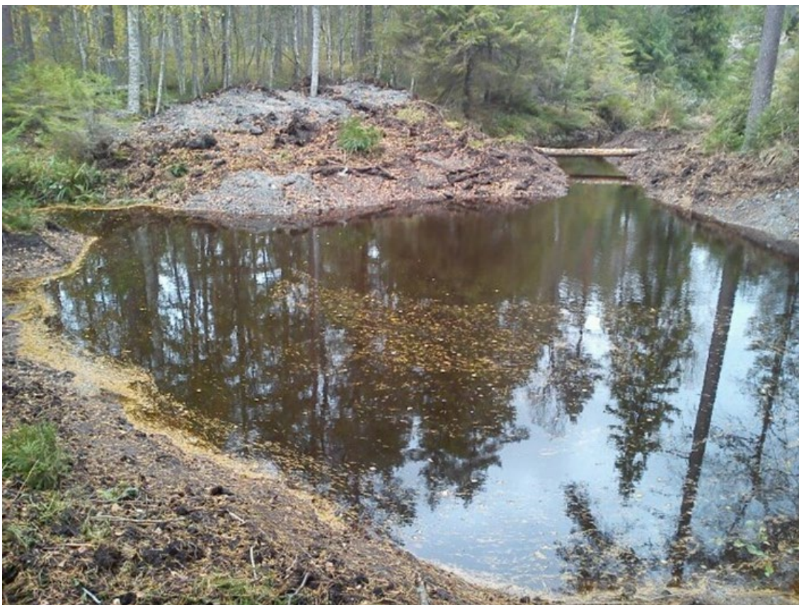
Figur 10. Sedimentationsdamm (cirka 15 meter i diameter) anlagd nära en väg i slutet av ett större dikessystem. Notera dikets in- och utlopp som ligger på samma sida för att vattnet ska uppehålla sig så länge som möjligt i dammen. Foto: Jenny Stendahl
