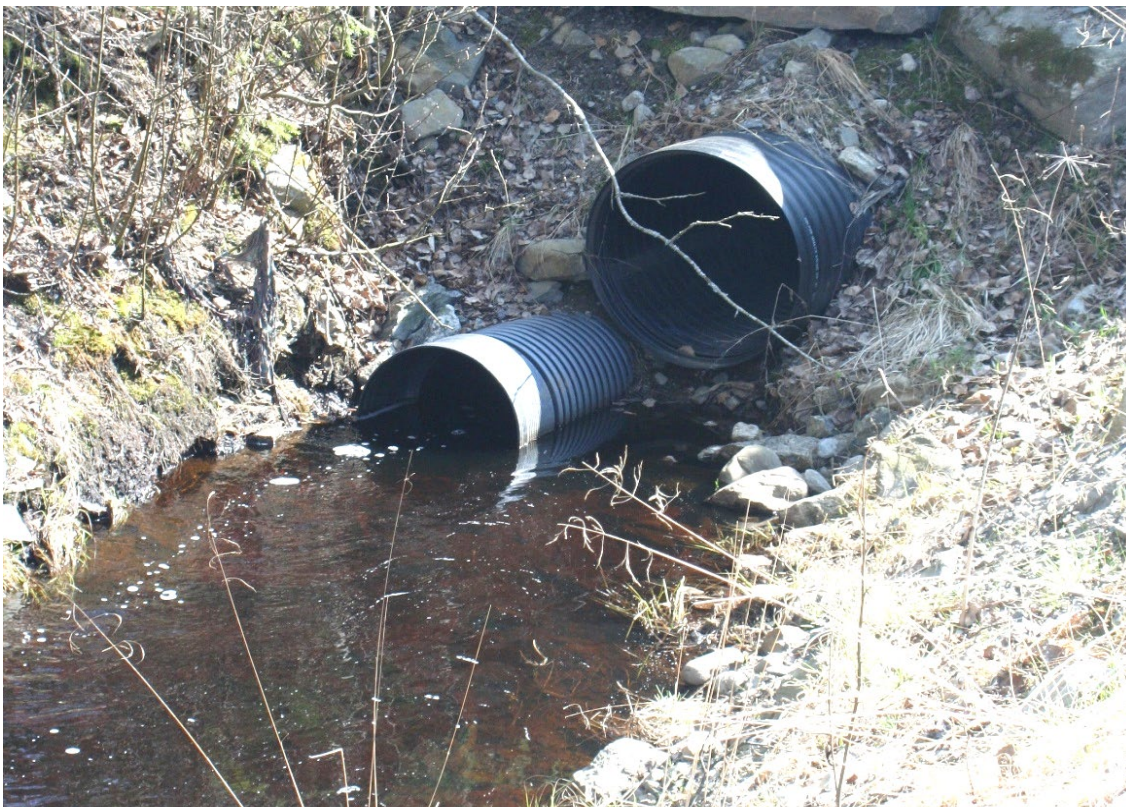
Figur 8. Flödesreglerande trummor kan bidra till att hålla vatten längre i dikessystemet och minska risken för översvämningar nedströms. Foto: Elisabet Andersson
